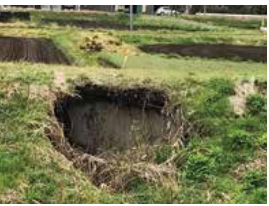
陥没した堤防 (川辺町中山田)
