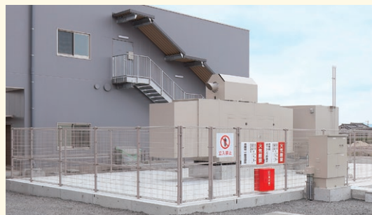
自家発電設備
