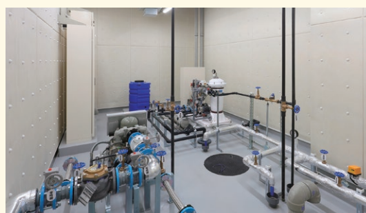
雨水ろ過ポンプ室
