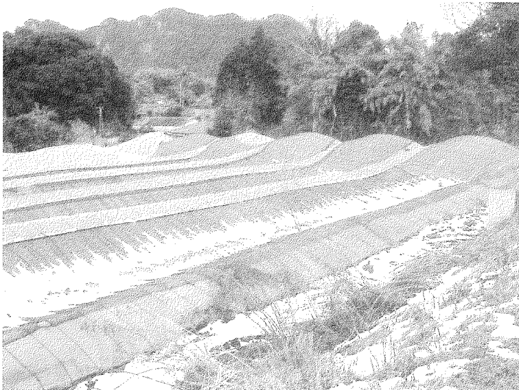
【倒壊ハウスの被害の状況 共済組合提供】
