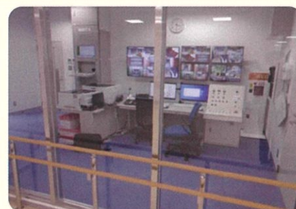
粗大ごみ処理施設 中央制御室
