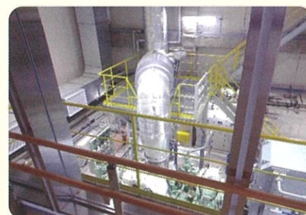
焼却施設 蒸気タービン発電機室
