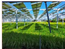
地区①の発電設備の外観
