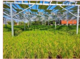
地区②の発電設備の外観
