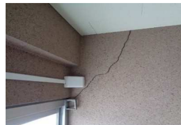
本館 壁クラック(3階廊)
