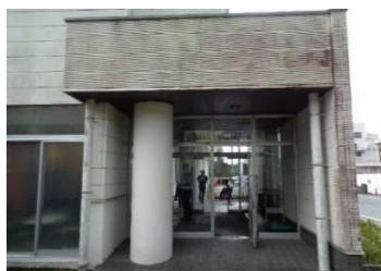
別館 外壁劣化(3階)
