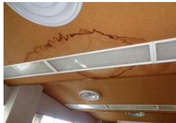
本館 雨漏り跡(3階)
