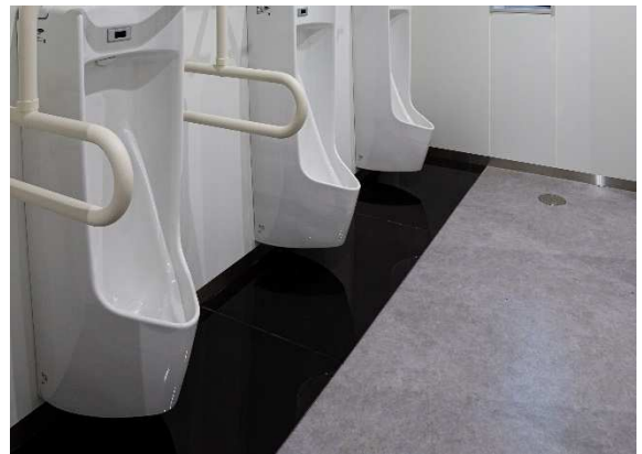
清掃等に配慮したトイレの事例(※)
