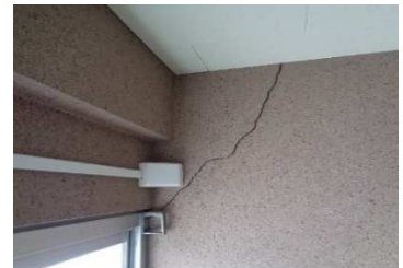
本館 壁ひび割れ(3階廊下)
