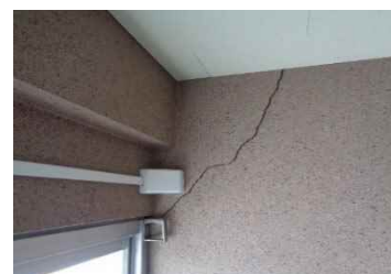
本館 壁ひび割れ(3階廊下)
