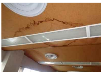
本館 雨漏り跡(3階)
