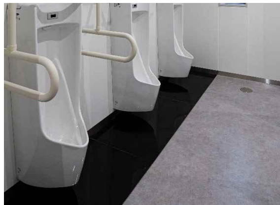
清掃等に配慮したトイレの事例(※)
