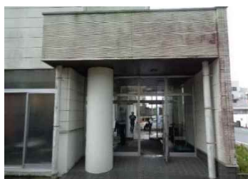
別館 外壁劣化
