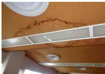
本館 雨漏り跡(3階)
