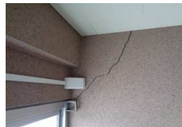
本館 壁ひび割れ(3階廊下)
