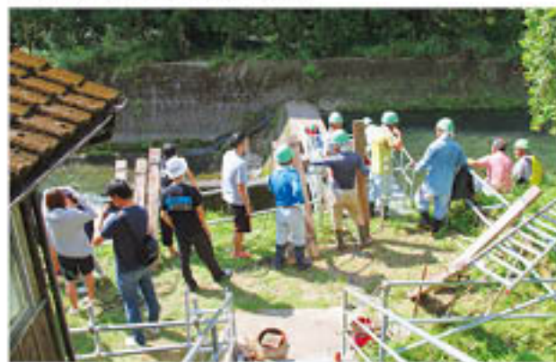
▲高田地区に受け継がれるタービン揚水施設を守るため、施設周辺の整備に取り組む皆さん。
