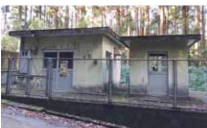
▲水道施設の老朽化も進んでいます
