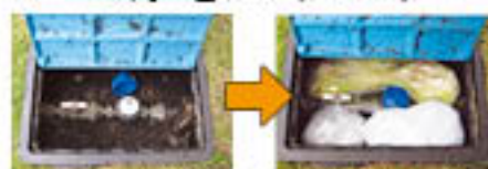
水道メーターの保温
