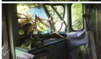
▲ JR九州用地外からの倒木発生事例
