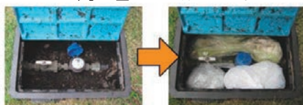
水道メーターの保温
