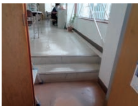
知覧庁舎西別館2階入り口の段差
