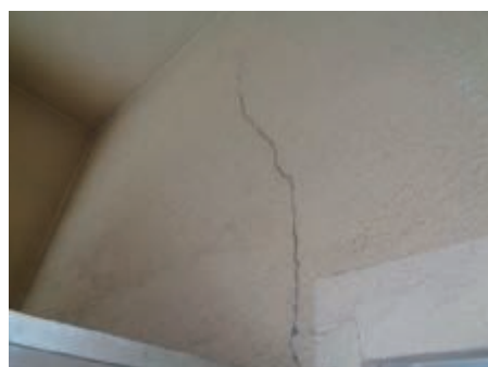
知覧庁舎本館階段室ひび割れの様子
