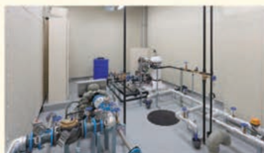
雨水ろ過ポンプ室
