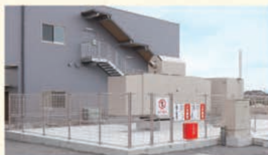
自家発電設備
