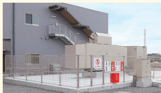
自家発電設備
