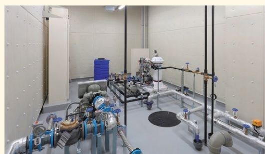
雨水ろ過ポンプ室
