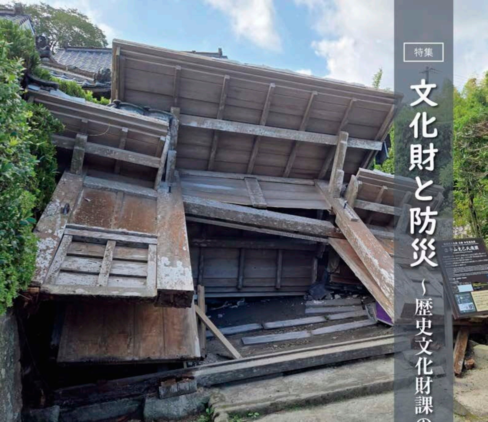
令和6年8月、台風による倒壊被害を受けた平山郡腕木門（左下は修理後）
