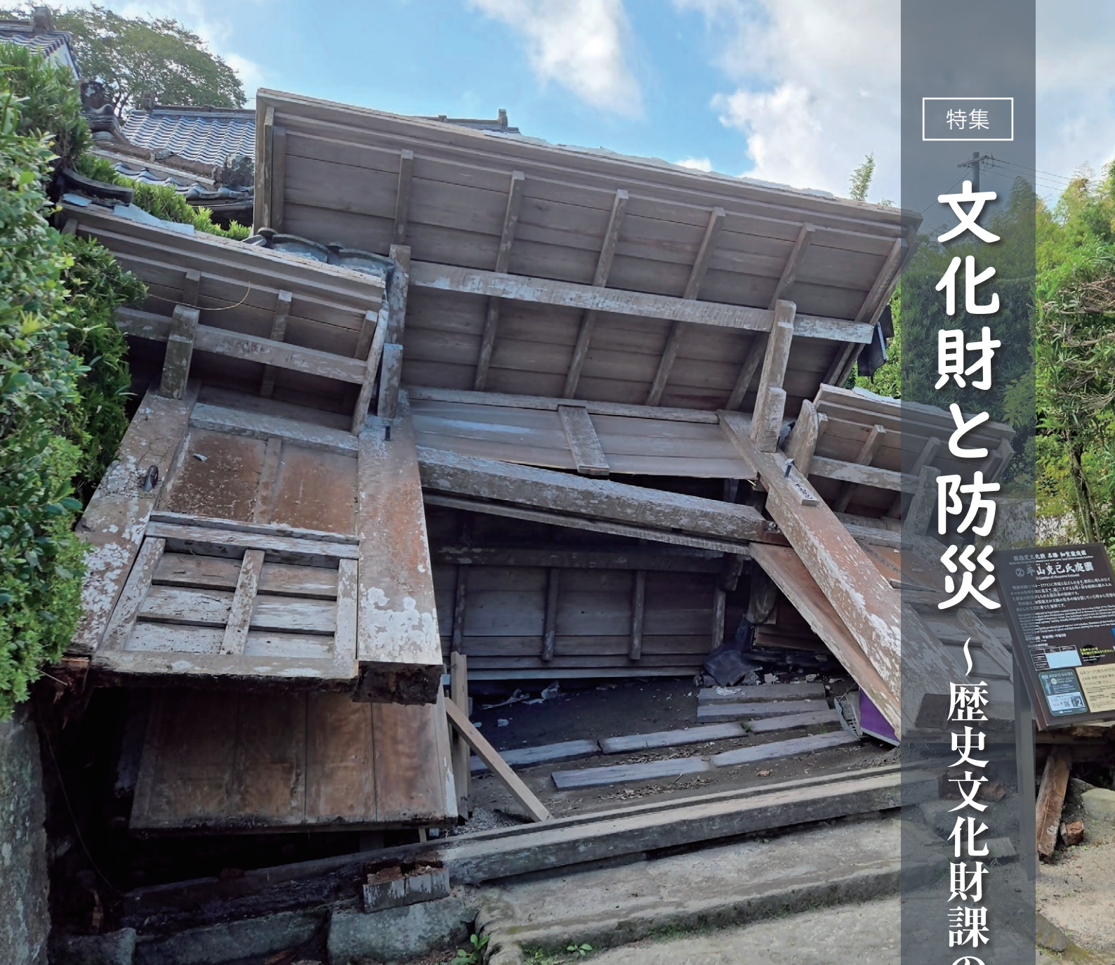
令和6年8月、台風による倒壊被害を受けた平山邸腕木門（左下は修理後）
